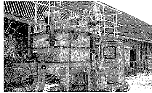
牛舎貯留槽横に設置した処理施設全景
