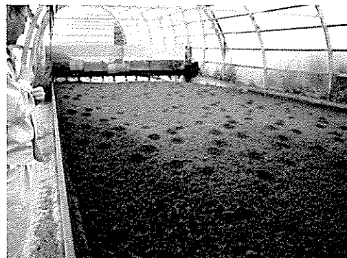
写真2 攪拌乾燥施設（最終部）
