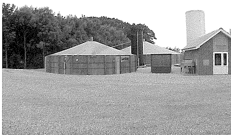
写真2 Lundsby Bioenergi社製個別型バイオガスプラント。左が前処理槽400 m 3 で奥が発酵槽13,000 m 3 。その間にある黒い縦型のタンクは脱硫槽で、右の白い縦型のタンクにはお湯が貯留してある。右の建物に制御装置、発電機、ポンプ等が集中して入っている。
