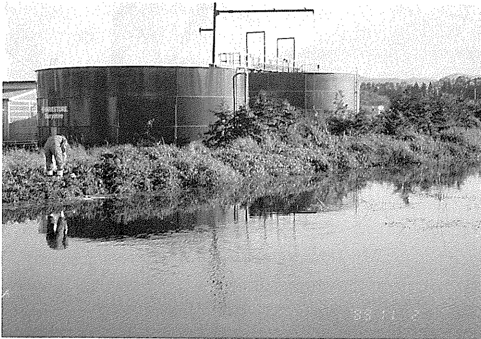
写真3. 複合ラグーンシステム（スラリーストアを改造）。回分槽（写真右側、475 m^3 ）で曝気・沈殿を行い、上澄水を貯留槽（写真左側、300 m^3 ）に送水する。さらに、貯留槽で沈殿を行った後、上澄水を池に放流している。
