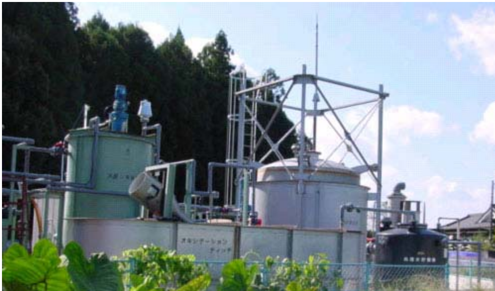
写真-1 プラント全景
