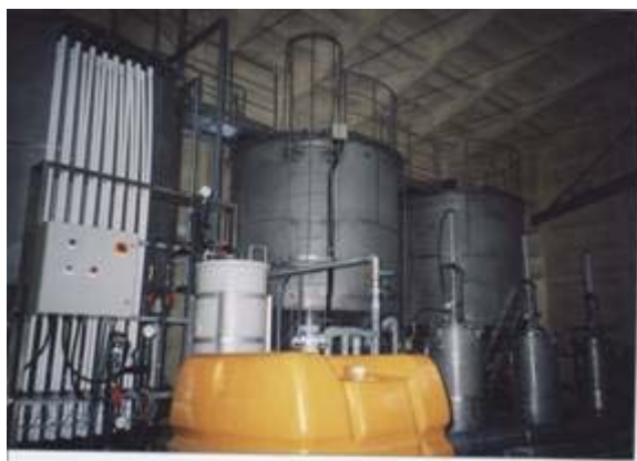
UF膜、サイクロン、クッションタンク
