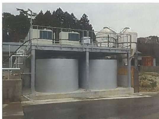
写真6 バイオガス発電設備
