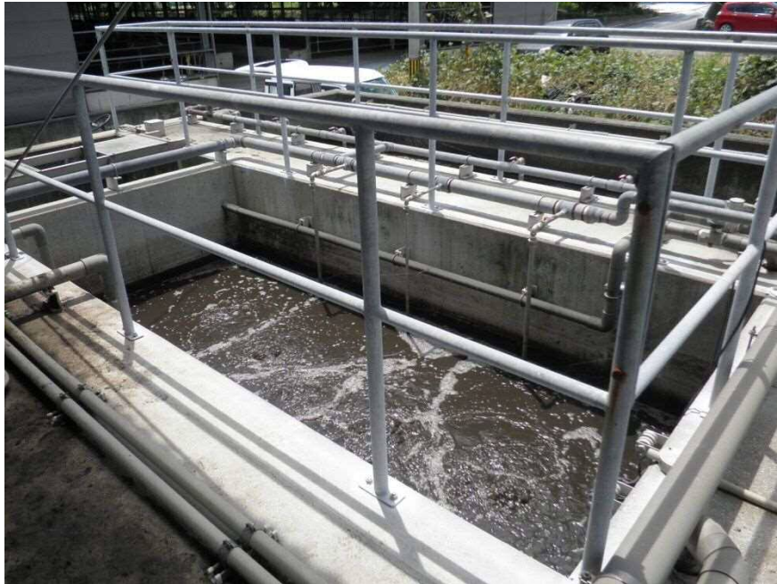
参考写真1 事業を活用して整備した汚水処理施設
