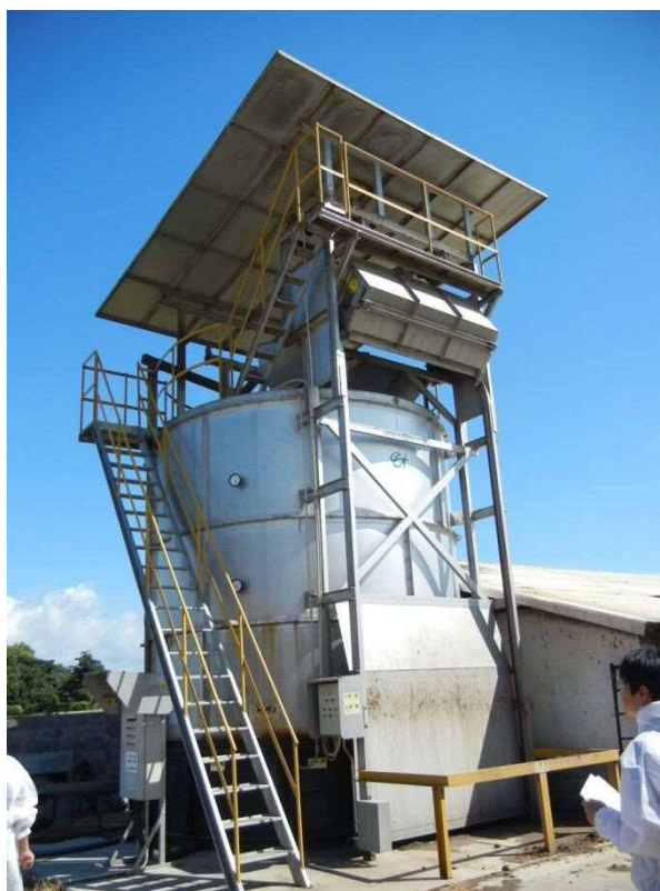
参考写真2 事業を活用して整備した縦型攪拌発酵処理施設
