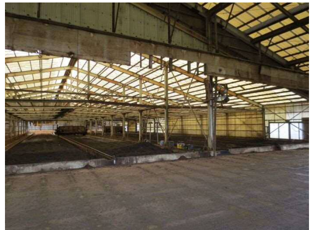
写真 1 老朽化が進む堆肥センター
