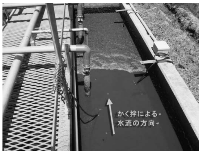
写真3 施設改修により脱窒機能を付加した施設のばっ気槽 (ばっ気停止・かく拌で脱窒による泡が発生しているところ)
