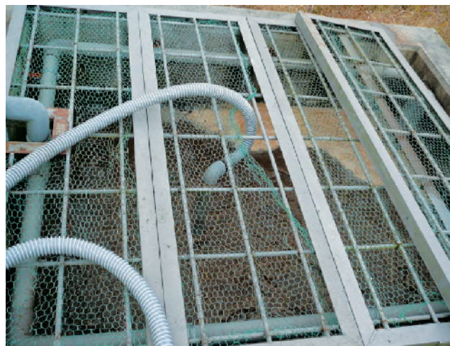
ミルクパーラー排水簡易処理施設
