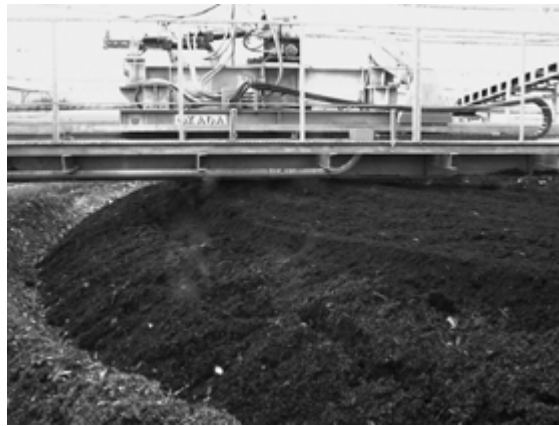
写真3 一次発酵棟(円型スクリー搅拌方式) 25日間で60~80℃で発酵
