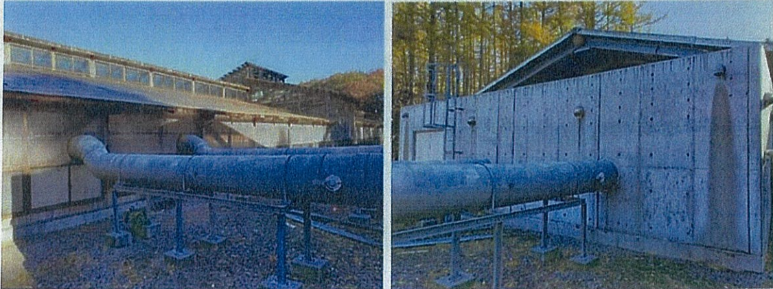
写真6 施設から臭気を送る配管(左)と脱臭施設(右)
