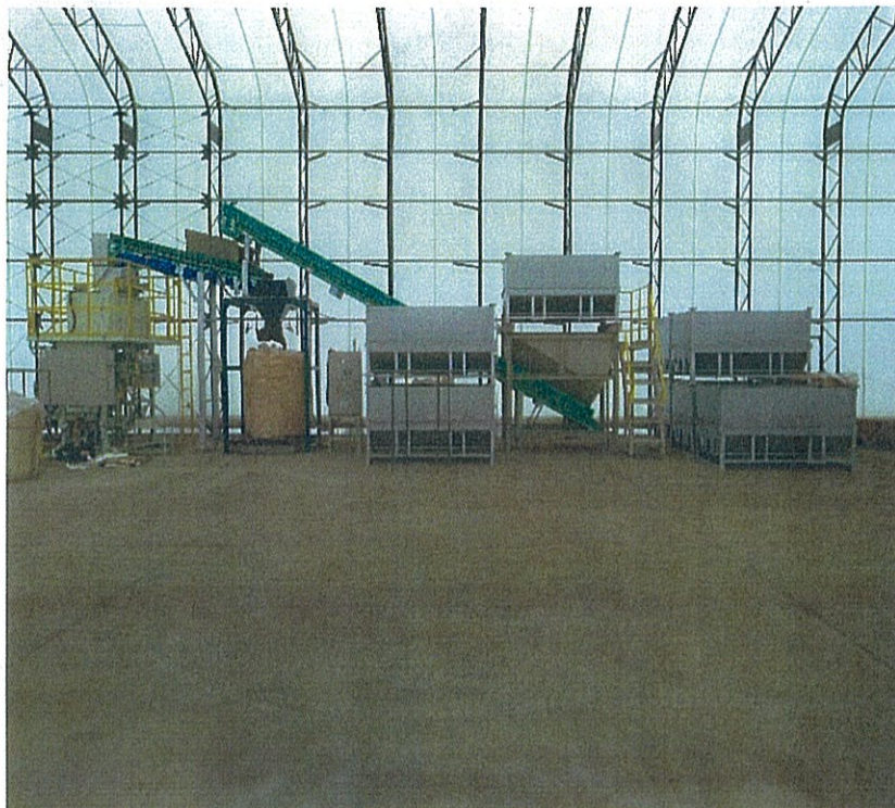
写真9 計量機とフレコン詰め・個別梱包装置
