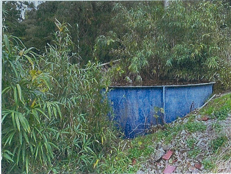
写真6 FRP製のタンクを利用した曝気槽(青色)
