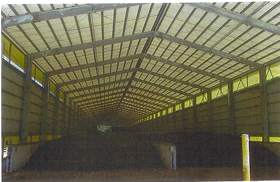
写真5 開放・直線型堆肥化装置
