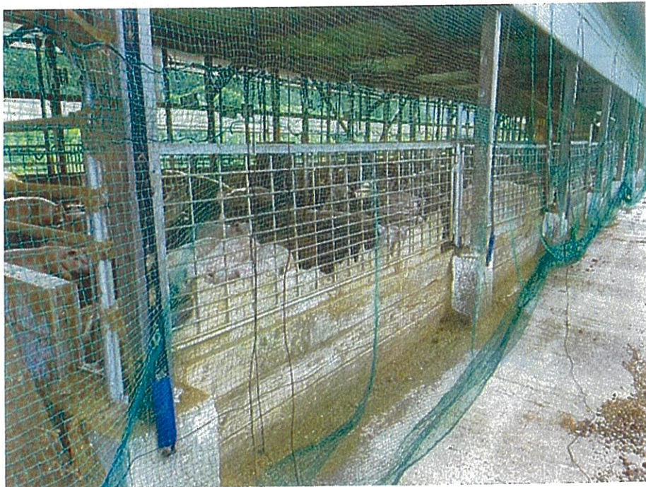
写真5 肥育豚舎のおが粉床の様子
