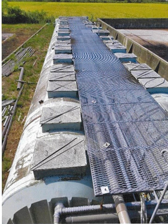
写真 6 浄化处理施設
