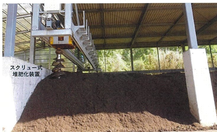
写真 2 スクリュー式攪拌装置設置堆肥化施設
