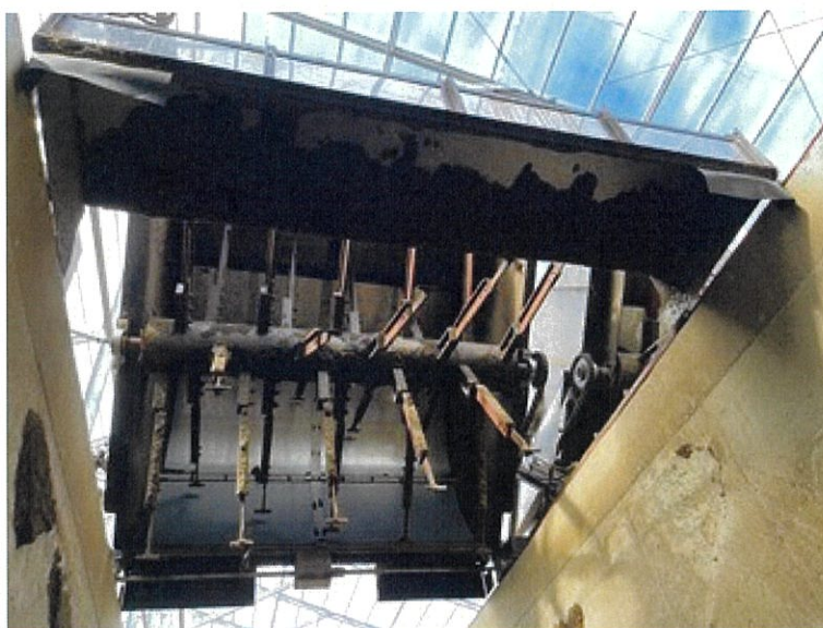
写真8 ロータリー式攪拌装置
