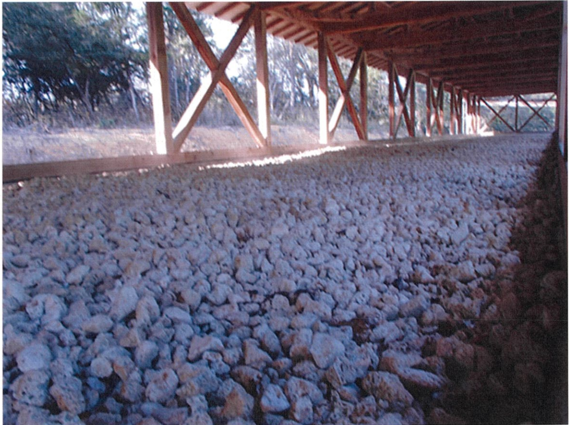
写真 5 ガラス発泡材を用いた生物脱臭槽
