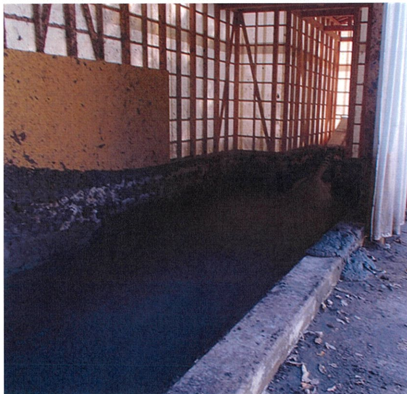
写真2 原料投入ピット
