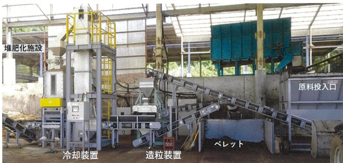
写真3 冷却施設付きペレット製造施設
