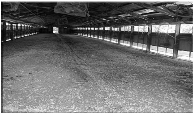
ブロイラー出荷後のふんの堆積状況
